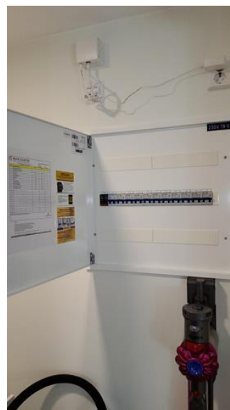
Elektrisk anlegg - [Sikringskap]
