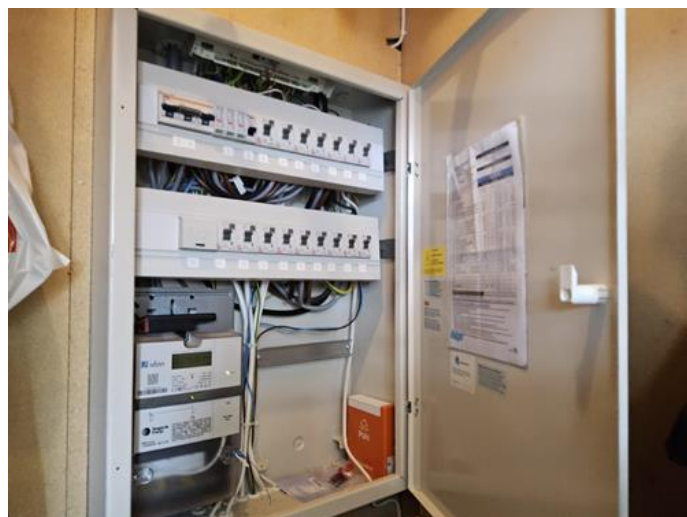
Elektrisk anlegg - [Sikringsskap]
