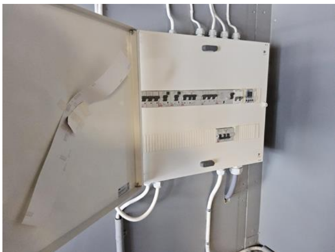
Elektrisk anlegg - [Sikringsskap garasje.]
