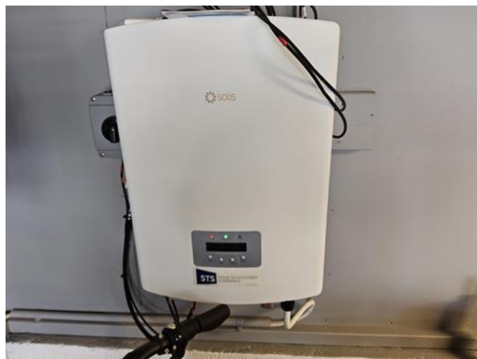
Elektrisk anlegg - [Opplegg for solcelleanlegg.]
