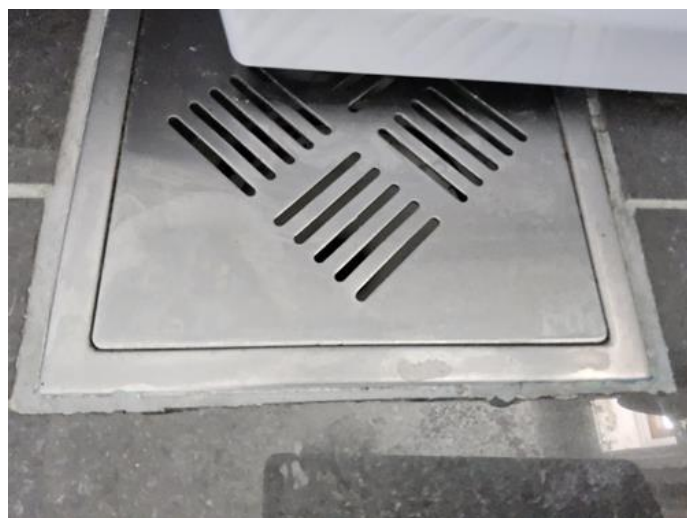
Avløpsrør (ink. sluk) - [Sluk vaskerom]
