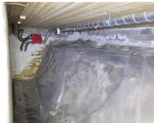
Innvendig inspeksjon - [Krypkjeller/avfuktningsanlegg.]
