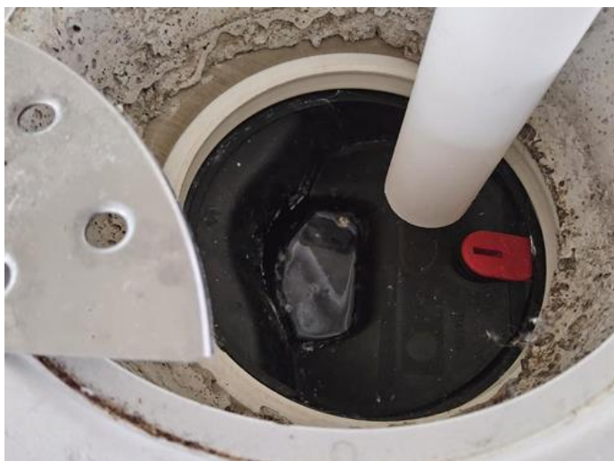
Avløpsrør (ink. sluk) - [Sluk bad 2. etg]
