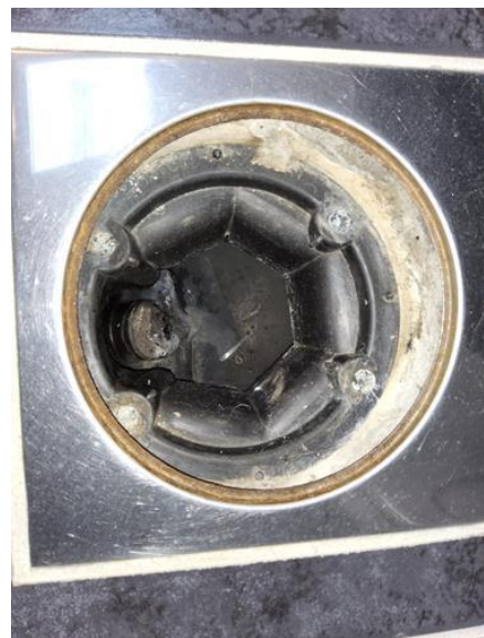
Membran, tettesjikt og overgang til sluk. - [Sluk i badrom i loftsetasje. ]
