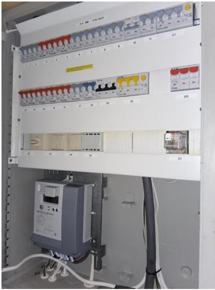
Elektrisk anlegg - [Sikringskap. ]
