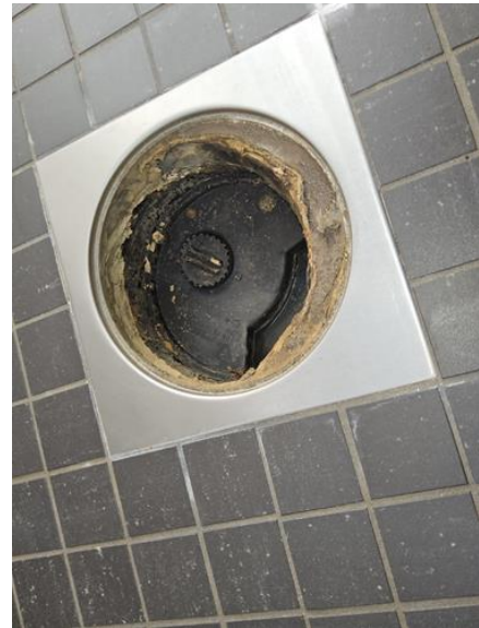
Avløpsrør (ink. sluk) - [Sluk bad 2. etg]
