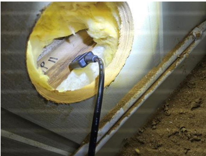
Konstruksjoner (tilfargerulv, himling og vegger). - [Symptomer på fuktskade i utlekket kjellervegg.]
