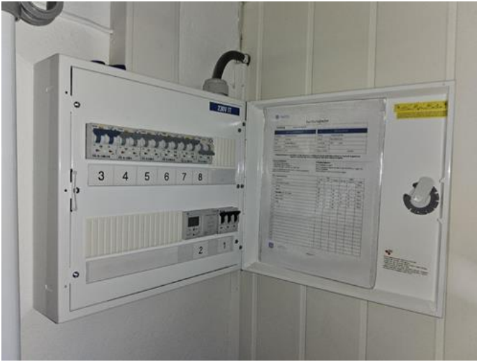
Elektrisk anlegg - [Sikringskap kjeller]
