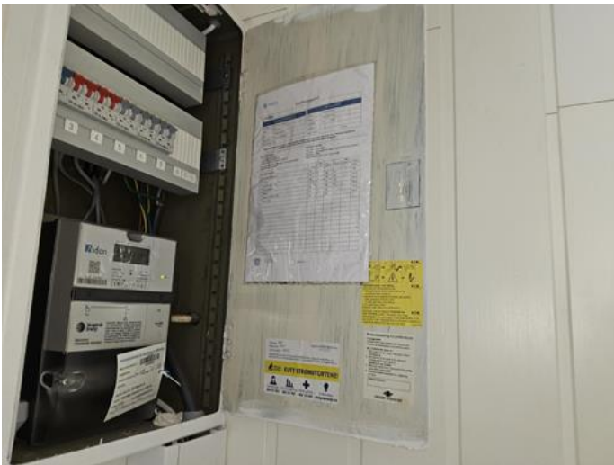
Elektrisk anlegg - [Sikringskap 2. etg.]
