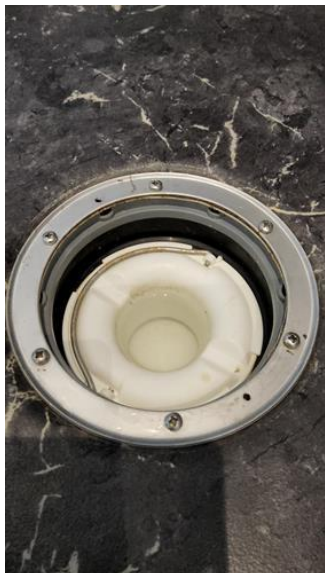
Avløpsrør (ink. sluk) - [Sluk 2 bad 1. etasje]
