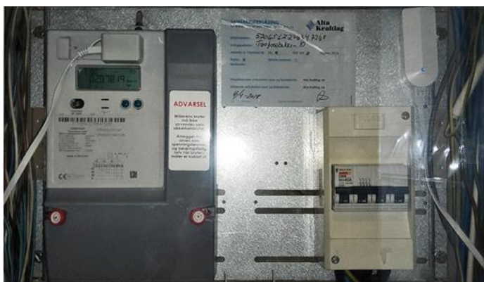
Forenklet vurdering av det elektriske anlegget - [AMS- måler]
