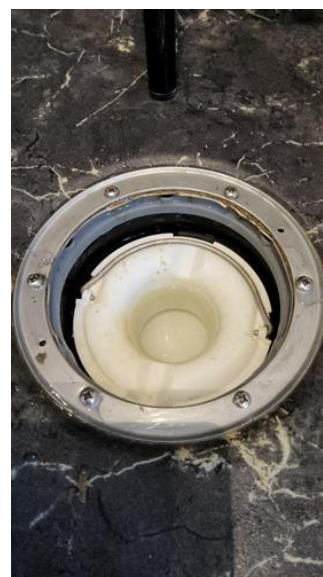
Avløpsrør (ink. sluk) - [Sluk 1 bad 1. etasje]
