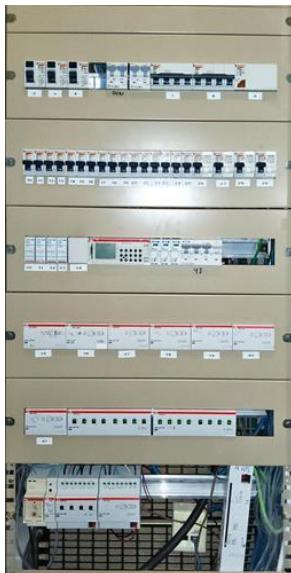
Forenklet vurdering av det elektriske anlegget - [Sikringskap teknisk rom]
