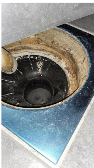
Avløpsrør (ink. sluk) - [Sluk bad loftsetasje]
