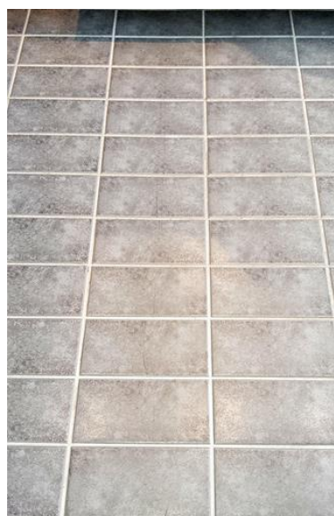
Overflater gulv - [Sprekker i badegulv]
