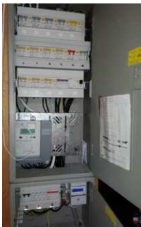
Elektrisk anlegg - [Sikringskap]
