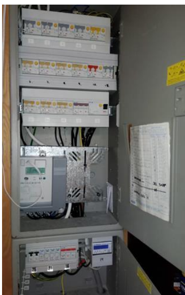
Elektrisk anlegg - [Sikringskap ]
