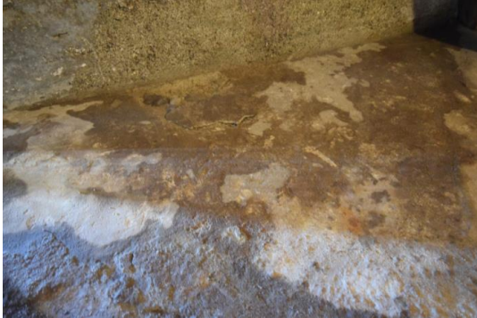
Fukt i kjeller.
