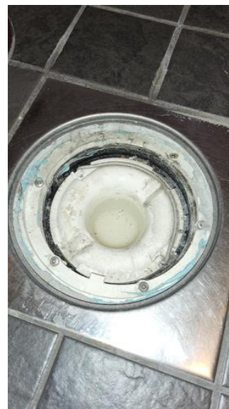
Avløpsrør (ink. sluk) - [Sluk vaskerom]
