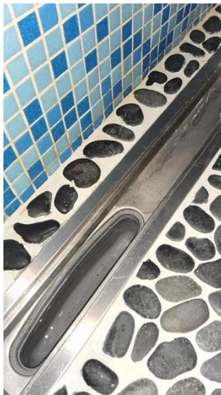
Avløpsrør (ink. sluk) - [Sluk bad underetasje i dusj]
