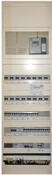
Forenklet vurdering av det elektriske anlegget - [Sikringsskap]
