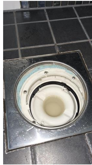
Avløpsrør (ink. sluk) - [Sluk bad 1. etasje]
