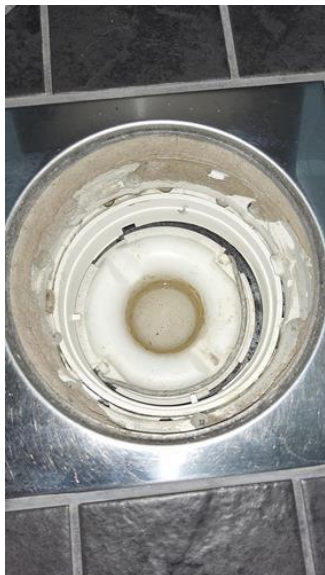
Avløpsrør - [Sluk toalettrom]
