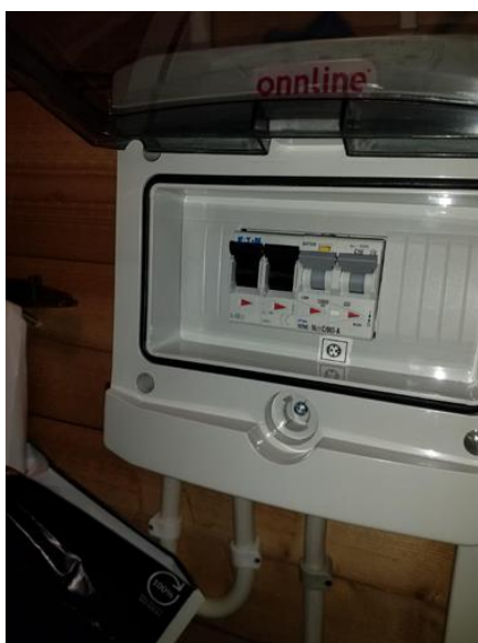
Beskrivelse - [Sikringskap i bod i forbindelse med oppstillingsplass ]
