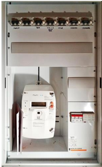
Forenklet vurdering av det elektriske anlegget - [Sikringskap]
