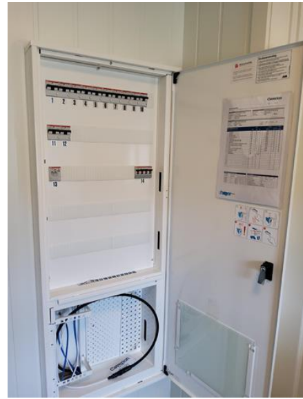
Elektrisk anlegg - [Sikringskap]
