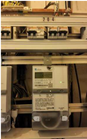
Elektrisk anlegg - [Sikringskap. ]
