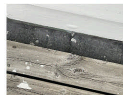
Observert sprekke dannelse i papptekking.
