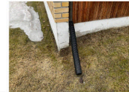
Taknedløp fra veranda ført ut på terrenget.
