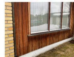
Krypprom uten adkomst under tilbygg mot sørvest.
