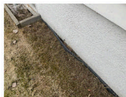
Klemlisten har løsnet fra muren.
