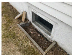
Terreng har krøpet over grunnmursplaten.
