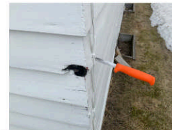
Antydning til råte ved et hjørne.
