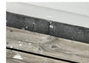
Observert sprekke dannelse i papptekking.
