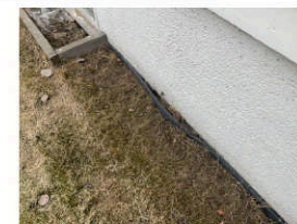
Klemlisten har løsnet fra muren.
