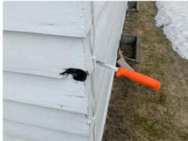
Antydning til råte ved et hjørne.
