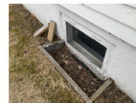
Terrenget har krøpet over grunnmursplaten.
