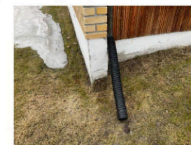
Taknedløp fra veranda ført ut på terrenget.
