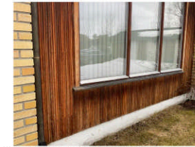
Krypropp uten adkomst under tilbygg mot sørvest.
