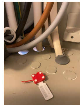
Utette kabelgjennomføringer i hovedskap.
