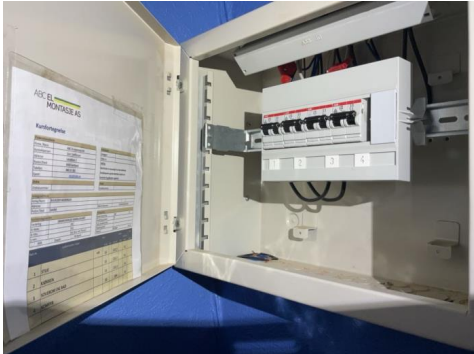
Fordelerskap i første etasje.
