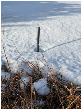
Utvendig stoppekran på vannledning.
