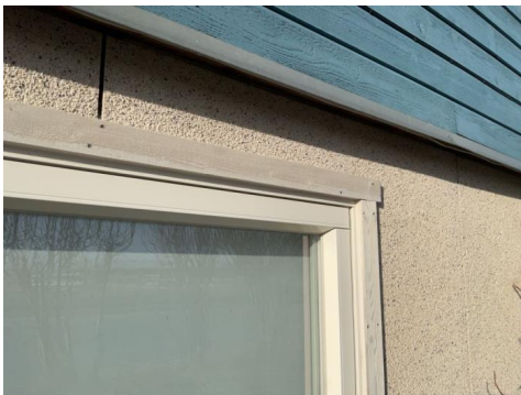
Eksempel på manglende beslag i overkant.
