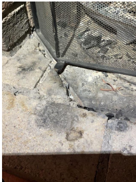
Sprekker i fuge ved peisinnsetts.
