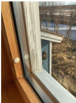
Eksempel på værslitasje og vedlikeholdsbehov.
