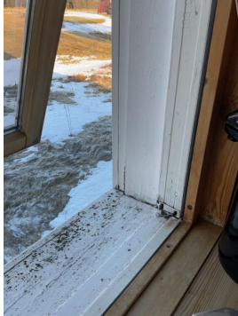
Eksempel på uheldig utførelse utvendig med økt risiko for skade.
