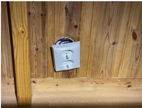
Løs stikkontakt i stue/kjøkken.
