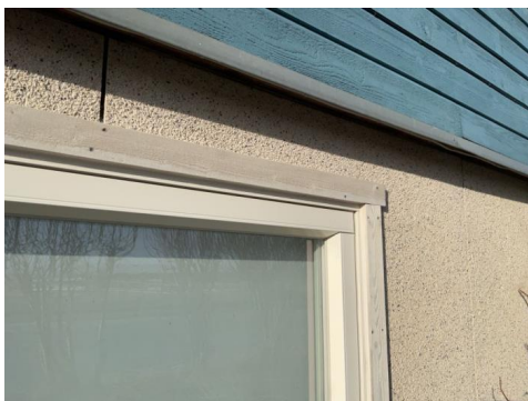
Eksempel på manglende beslag i overkant.
