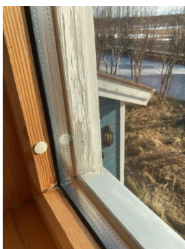
Eksempel på værslitasje og vedlikeholdsbehov.
