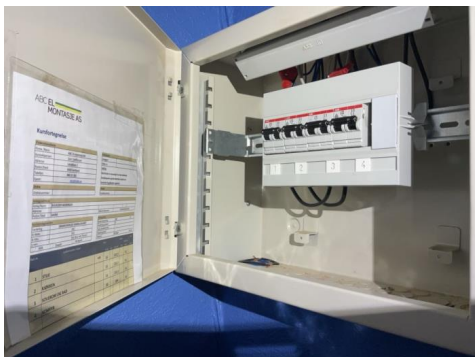
Fordelerskap i første etasje.
