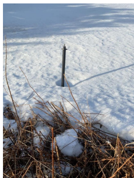
Utvendig stoppekran på vannledning.
