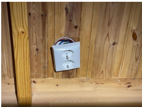
Løs stikkontakt i stue/kjøkken.
