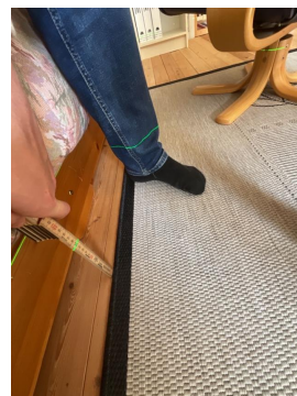
Høydeforskjell på cirka 15mm innenfor 2 meter.
