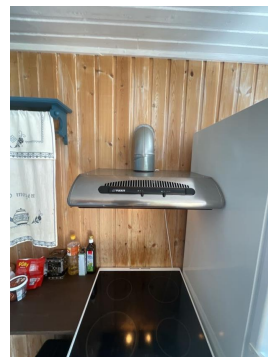
Kjøkken ventilator med avtrekk ut.
