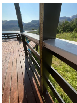
Rekkverks høyde utfor gang er 74 cm.
