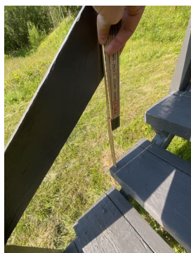
Rekkverks åpning på cirka 32 cm.
