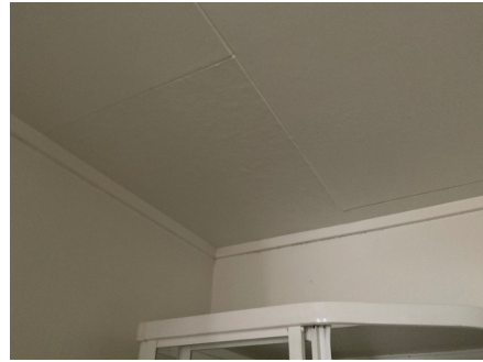
Fuktmerker i himlingsplater over dusj
