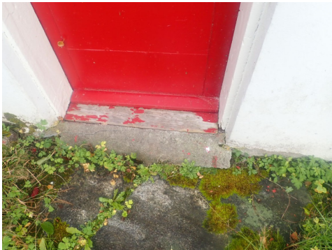
Råteskader dørterskel - utett under dør
