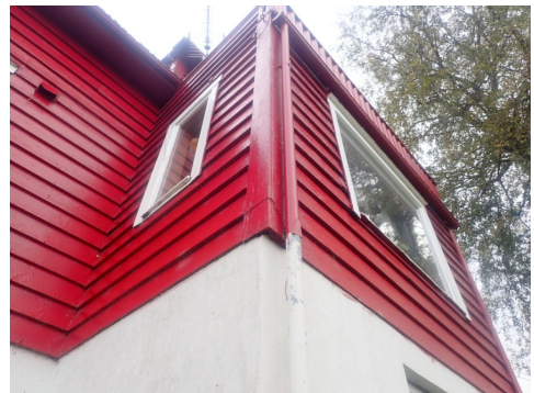
Ingen lufting - eldre kledning
