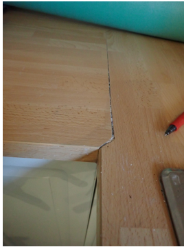
Dårlig finisih - lite fagmessig skjøt benkeplate
