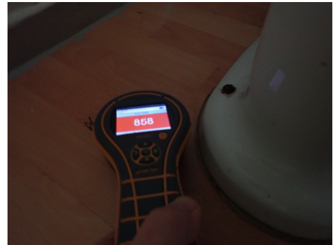
Fuktskade i golv
