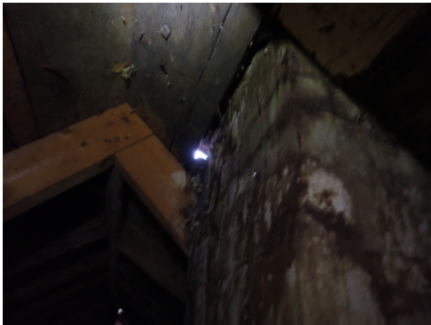
Hull i undertak ved pipe - ser dagslys.
