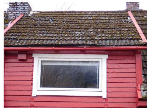
Veldig mosegrodd og deformasjoner i takkonstruksjonen
