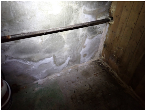
Fukt synlig innvendig mur i bakkant
