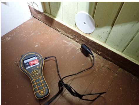
Forhøyet fuktverdi tregolv i stue underetasje og store synlige råteskader i golv i bodrom mot nordvest.
