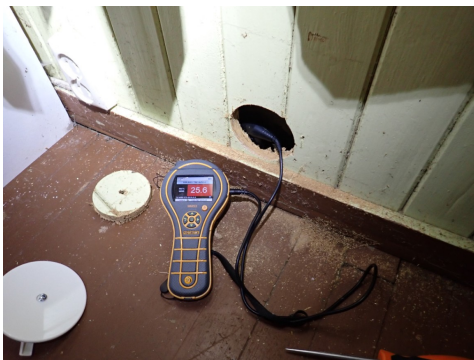
Råteskader i utforingsvegg mot mur i stue vest
