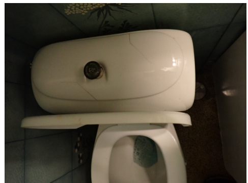
Sprekker i lokk sisterne toalett
