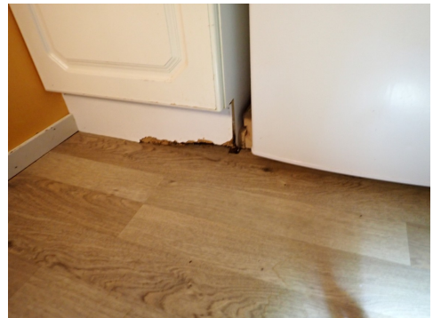
Skade i sokkel under høyskap
