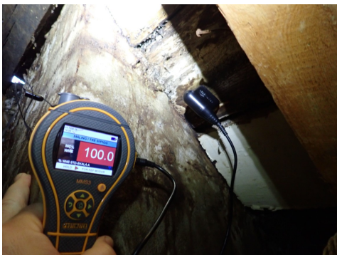
Målt 100 % fukt i treverk med store råteskader
