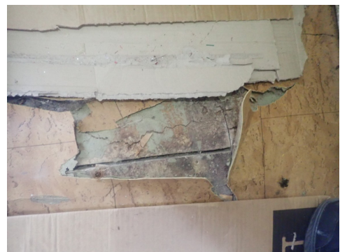
Råteskader i oppforet tregolv - trækker gjennom golv.
