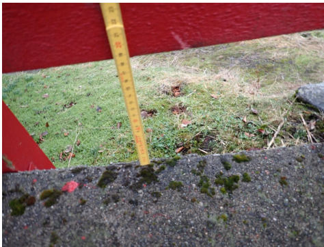
For store åpninger i rekkverk
