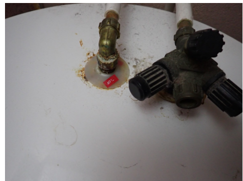
Rustskader i toppen
