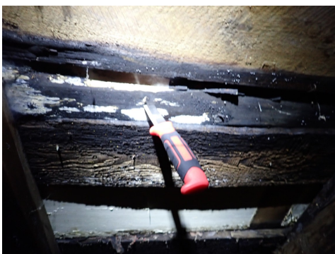
Omfattede råteskader i takkonstruksjonen
