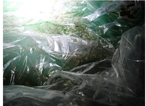
Fritt vann på utlagt plastfolie på golvet
