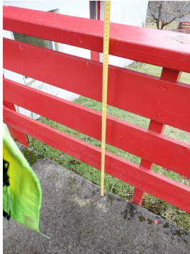
Rekkverk for lavt med for store åpninger
