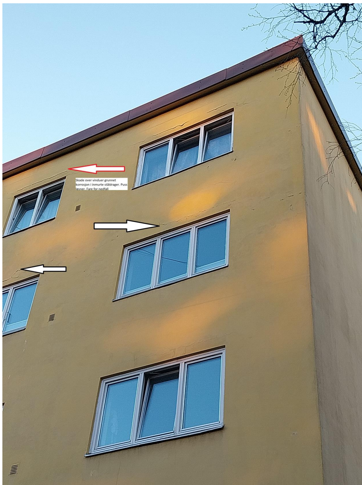
Skader i overdekninger/innmurt drager
