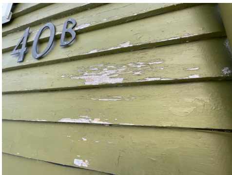
Del av kledning med mangelfull behandling.
