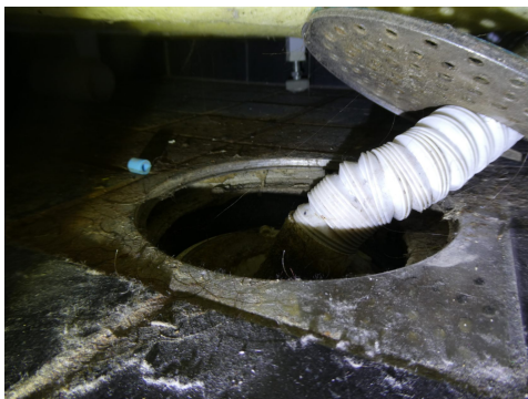
Sluk med avløp fra dusjkabinett.
