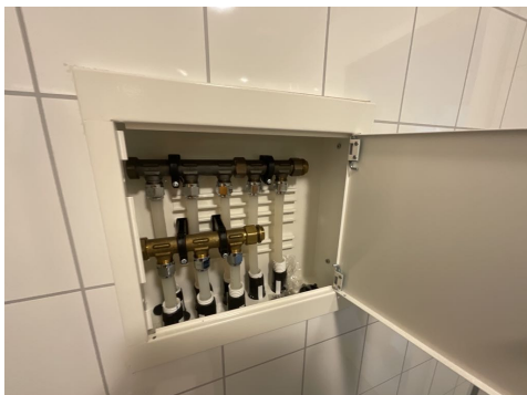
Fordelerskap for rør i rør-installasjon. Ingen kursfortegnelse.
