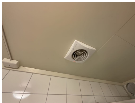
Avtrekksvifte i himling.
