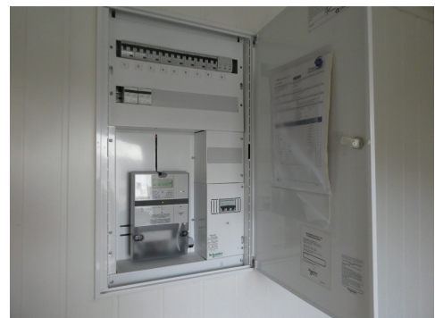
Elektrofordeler for hovedenhet.
