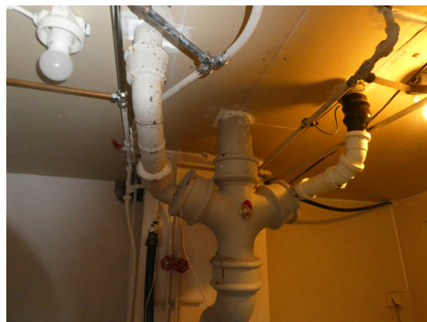
Utsnitt av avløpsrør i kjeller.
