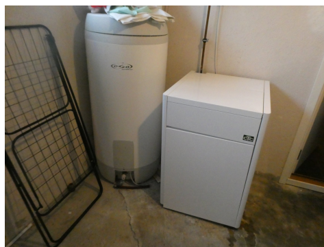
Varmtvannstanker - OSO til venstre og CTC til høyre.
