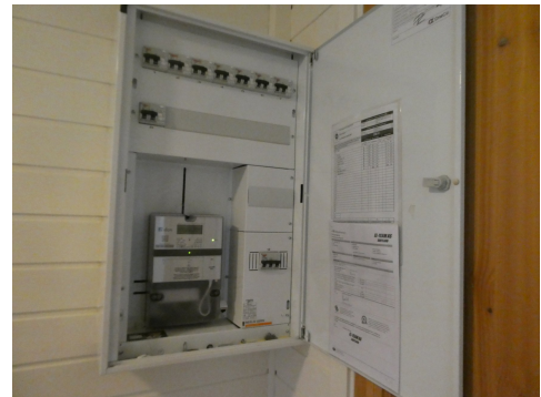
Elektrofordeler i kjeller.
