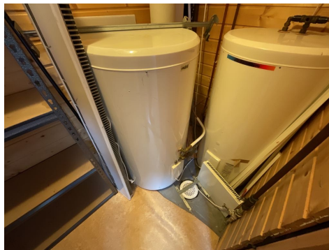
Varmtvannstanker i bod på kjellerplan.
