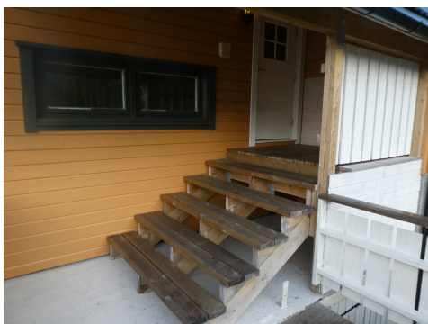
Øverste del av trapp - ingen rekkverk.
