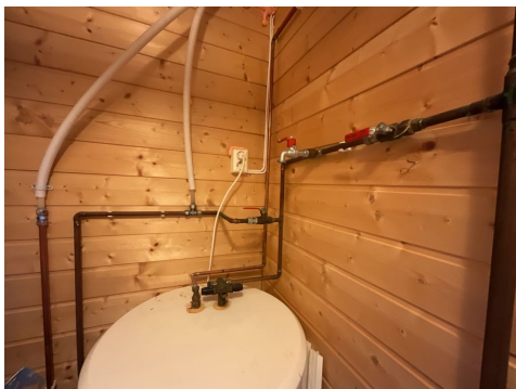
Utsnitt av rørinstallasjon.
