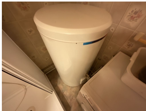
Varmtvannstank på loftplan.
