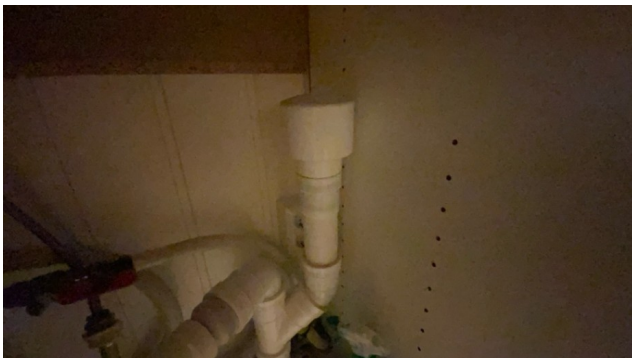
Lufting av avløp via durgo-ventil i kjøkkenbenk på loftplan.
