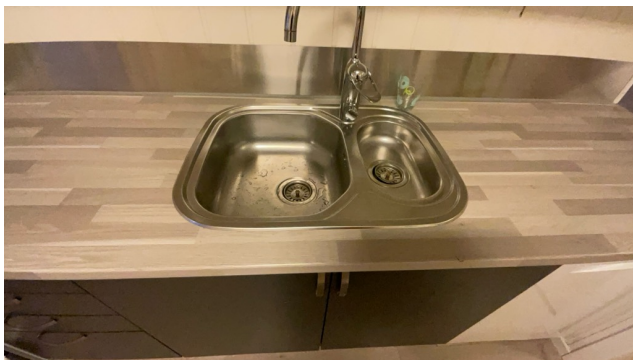
Kumbeslag med to kummer innfelt i benkeplate.
