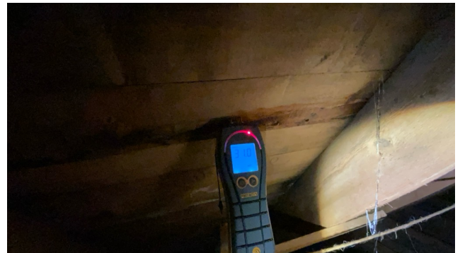
Registrert forhøyede fuktverdier på undertak - intervallet fra 24 til 31%.
