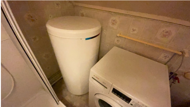
Varmtvannstank montert på bad/vaskerom på loftplan.
