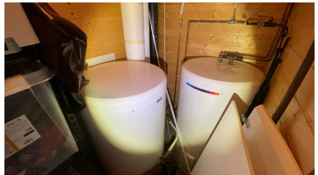
Varmtvannstanker montert på bod i kjeller.
