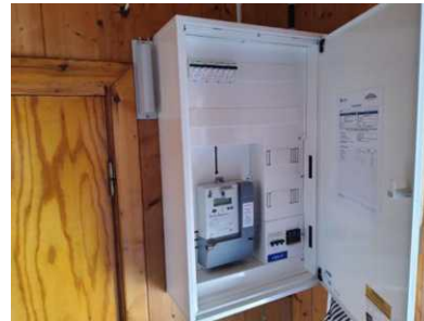
Elektrisk anlegg - [Sikringskap]
