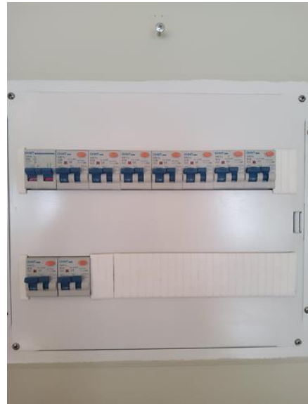
Elektrisk anlegg - [Sikringskap ]
