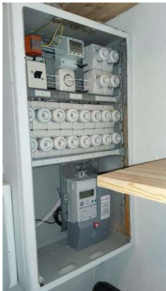
Forenklet vurdering av det elektriske anlegget - [Sikringskap]
