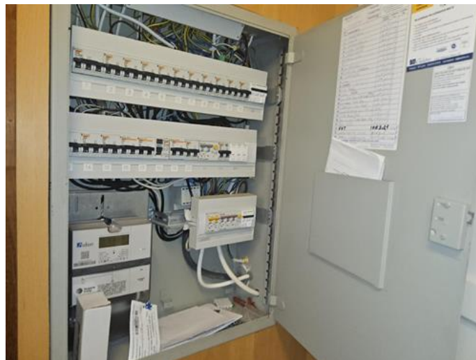
Elektrisk anlegg - [Sikringsskap]
