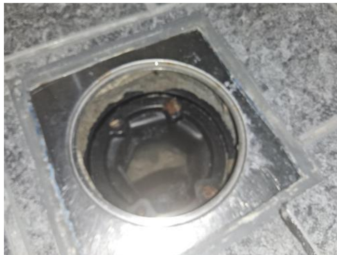
Avløpsrør (ink. sluk) - [Sluk vaskerom]
