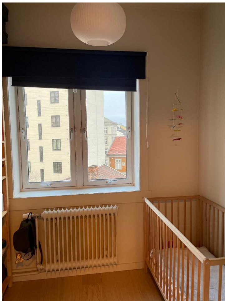
Figur 5: Soverom uten lufteventil
