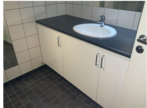
innredning med mindre fuktsvelling i nedkant av fronter
