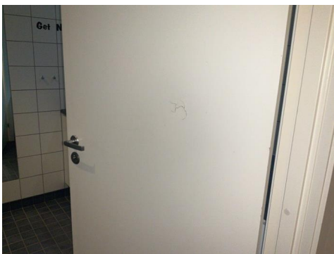
skade dørblad bad
