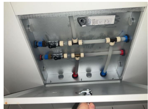
vanntilkobling i tak
