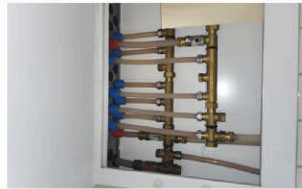
Vannrør [Sjekkpunkter utover det som er inkludert i andre rom] - [Fordeleskap for rør-i-rør system]
