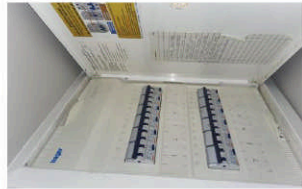
Elektrisk anlegg - [Sikringskap]
