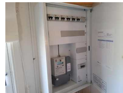
Elektrisk anlegg - [Sikringskap]
