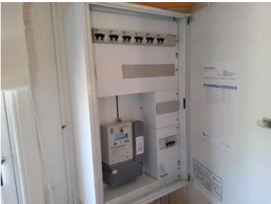
Elektrisk anlegg - [Sikringsskap]
