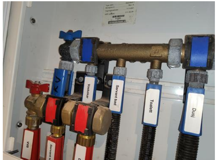
Vannrør - [Fukt i vannskap]
