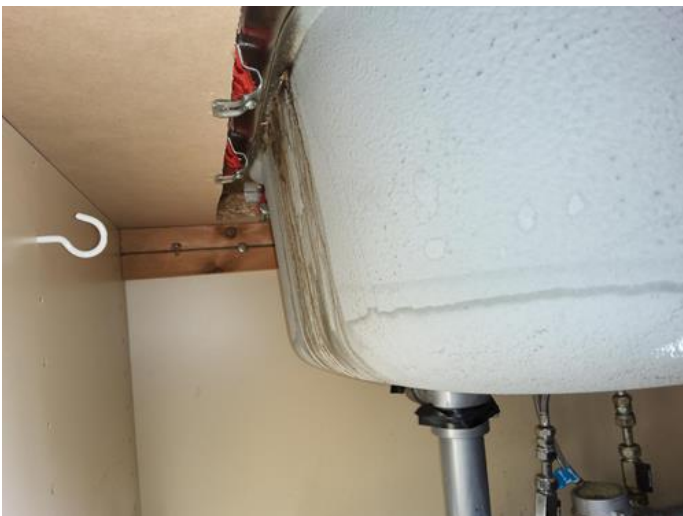
Innredning - [Lekkasje servant]
