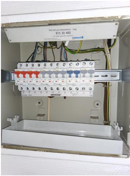
Elektrisk anlegg - [Sikringskap ]
