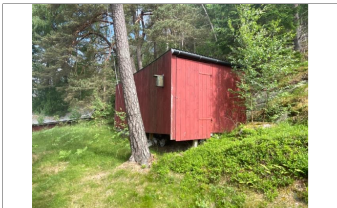
Enkelt skur uten gulv oppført i bindingsverk, fasader med malt kledning, pulttak tekket med takplater, malt paneldør. Skjevheter i konstruksjonen, kondemnerbart. Bygget er på ca. 18 kvm. Benyttes i dag som lager.
