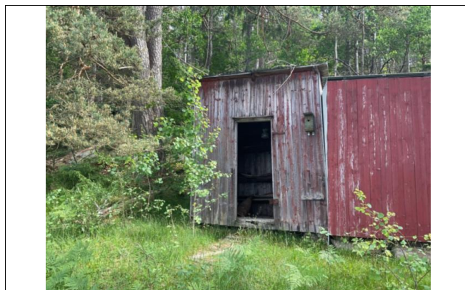
Bod oppført i bindingsverk, fasader med malt kledning, omfattende råteskader mm. Pulttak tekket med plater. Kondemnerbart. Boden er på ca. 5,5 kvm.
