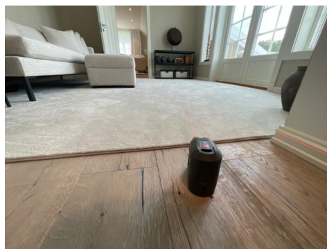
Nivellering loftstue, avvik ca. 10-20 mm
