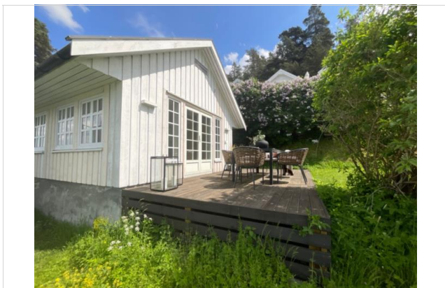
Terrasse i treverk, ca. 18 kvm. Mangler rekkverk (TG3)
