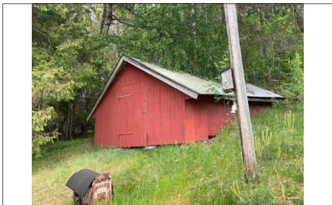
Båthus oppført i bindingsverk, fasader med malt kledning, saltak tekket med plater, malte panel dører, gulv i kun deler av bygget, omfattende skjevheter mm. Kondemnerbart. Båthuset er på ca. 30 kvm.
