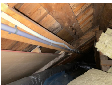
Generell opprydding, eldre undertak, noen eldre fukt skjolder mm.
