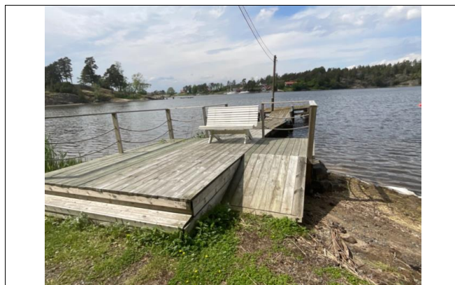
Bruksrett på bryggeanlegg. Anlegget har omfattende skjevheter mm. Ytterligere undersøkelser anbefales.
