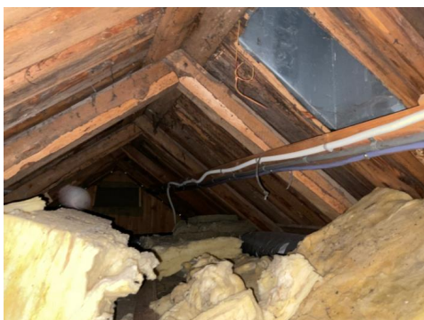
Eldre undertak og sperrer, eldre fukt skjolder mm. Ytterligere undersøkelser anbefales.
