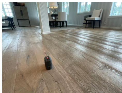
Nivellering stue/kj kken, avvik ca. 10-20 mm
