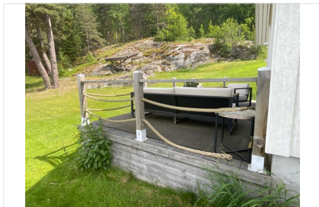
Terrasse i treverk ca. 17 kvm., rekkverk er ikke iht dagens forskrifts krav.
