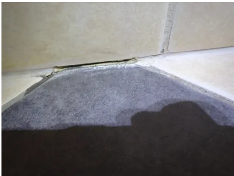
Skader i fuger i dusjhjørnet.
