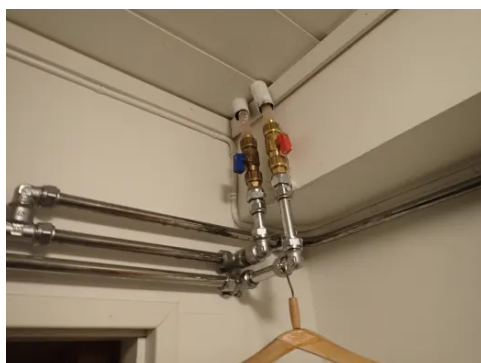
Åpen rørfordeling på vaskerom.
