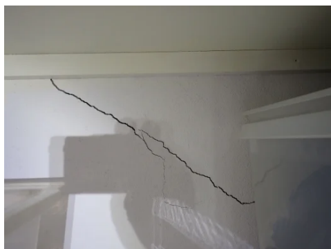
Sprekk i mur på bod i hoveddel
