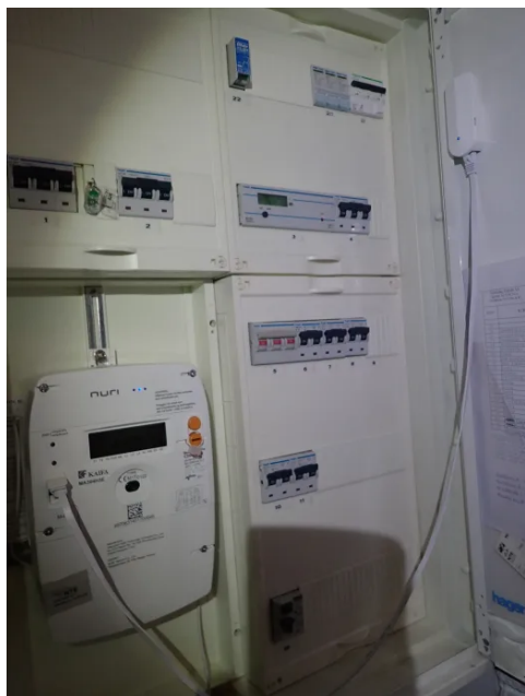
Sikringsskap i kjellertrapp
