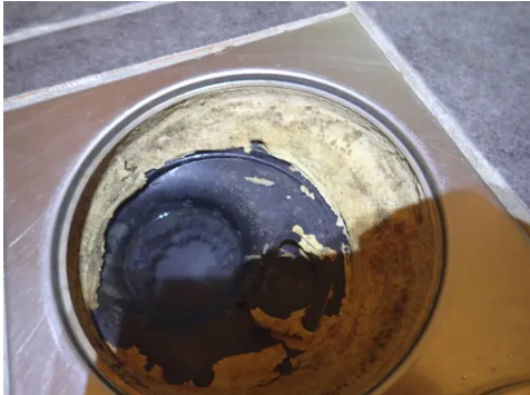
Synlig membran i sluk.
