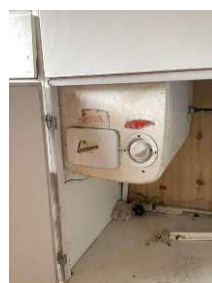
Varmtvannsbereder i kjøkkenbenk
