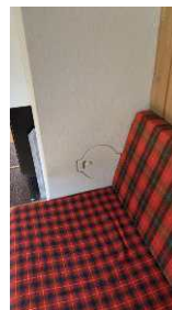
Det er brennbart materiale nærmere enn 300 mm fra sotluke/feieluke
