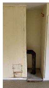
Ildfast plate mangler på gulvet under sotluke/feieluke på pipe.
