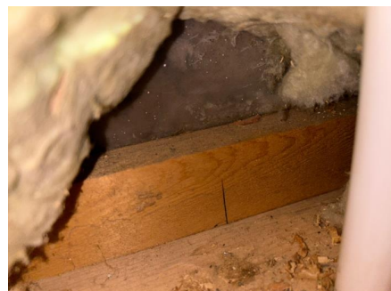
Synlig misfarging på bakside plater.
