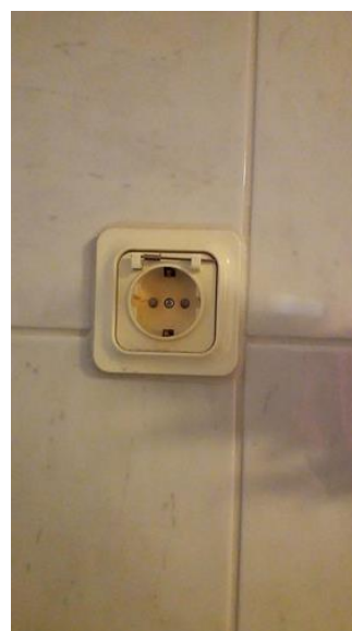
Forenklet vurdering av det elektriske anlegget - [Avvik]
