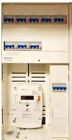
Forenklet vurdering av det elektriske anlegget - [Sikringsskap]
