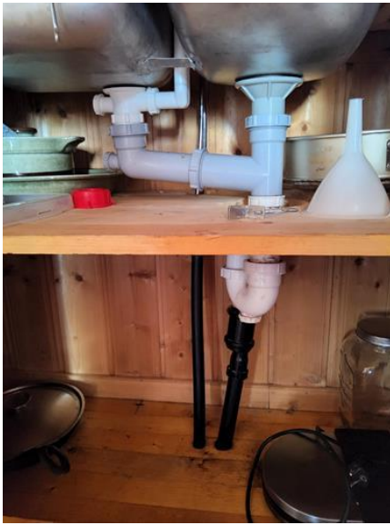
Kjøkken - [Røropplegg i kjøkkenbenk]
