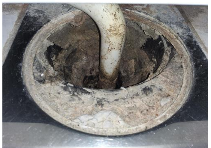
Avløpsrør (ink. sluk) - [Sluk, bad 2. etasje]
