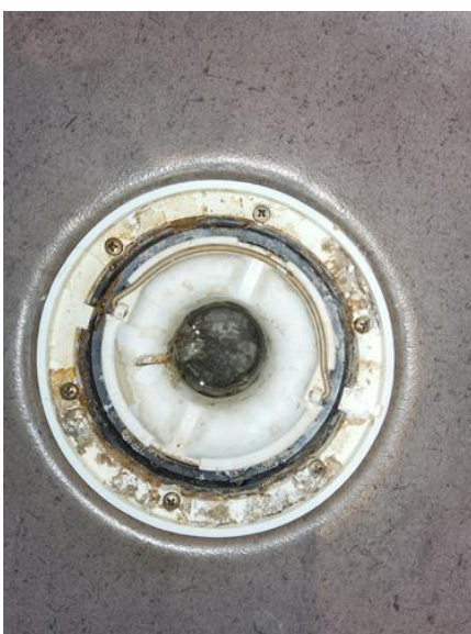
Avløpsrør (ink. sluk) - [Sluk, bad 1. etasje]
