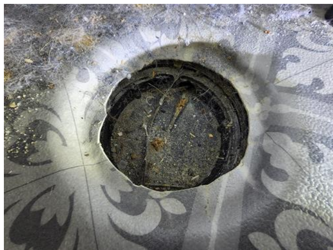
Avløpsrør (ink. sluk) - [Sluk, vaskerom]
