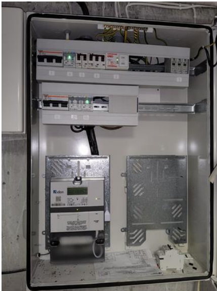
Elektrisk anlegg - [Sikringsskap teknisk rom]
