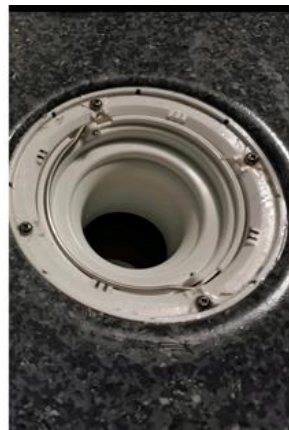
Avløpsrør (ink. sluk) - [Sluk bad]
