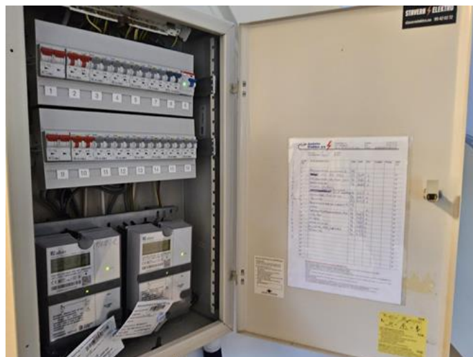
Elektrisk anlegg - [Felles sikringsskap]
