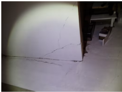
Sprekker i grunnmur ved trapp.
