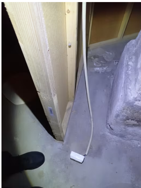
Løs ledning i kjeller.
