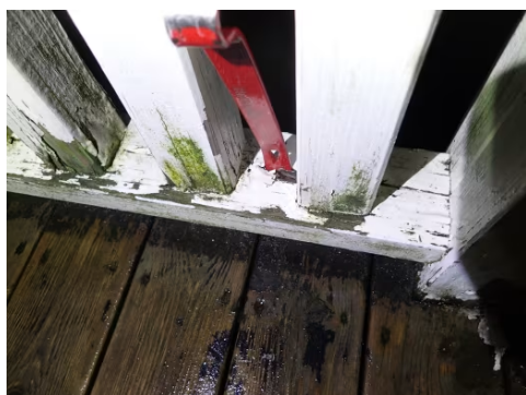
Lokal råteskade i nedre del av innfesting til rekkverkspiler på balkong i 2.etg.
