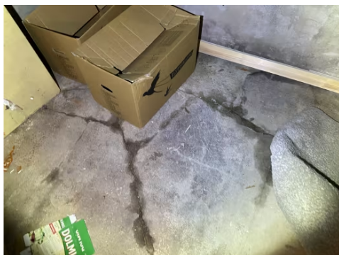
Det ble registreres fukttopptrekk fra sprekker i gulvstøyp ved en tidligere befaring i 2022.
