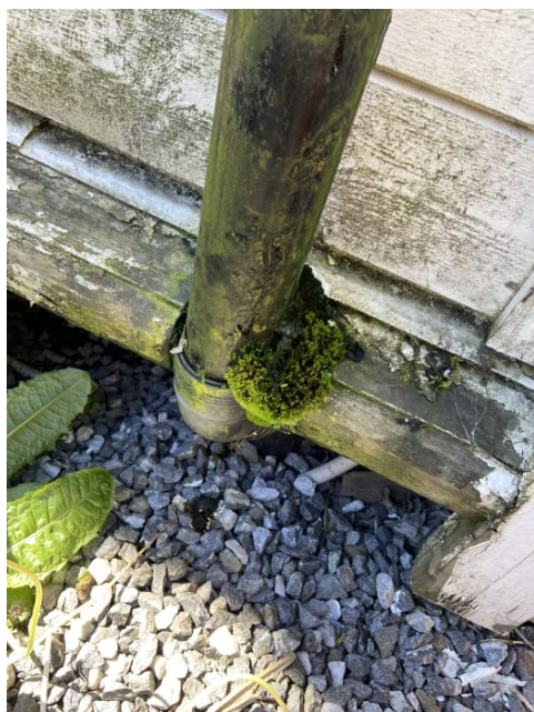
Utette skjøter fra nedløp takterrasse over inngangsparti
