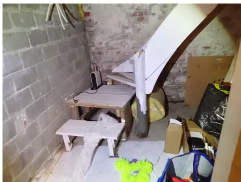
Bratt rapp ned til kjeller med manglende rekkverk og skader på nedre del av trapp.
