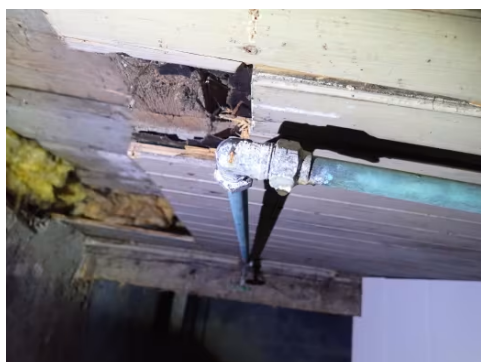
Eldre vannrør med lokal drypplekkasje fra skjøt/koblingspunkt.
