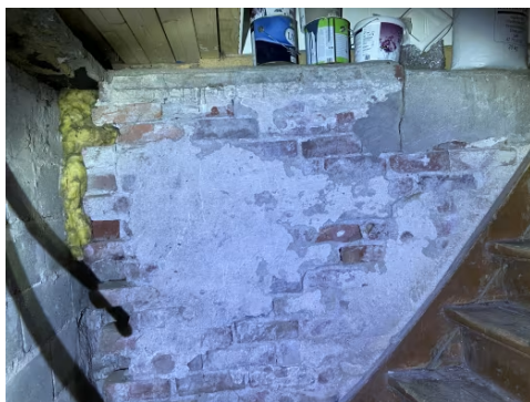
Sprekk i grunnmur ved trapp.
