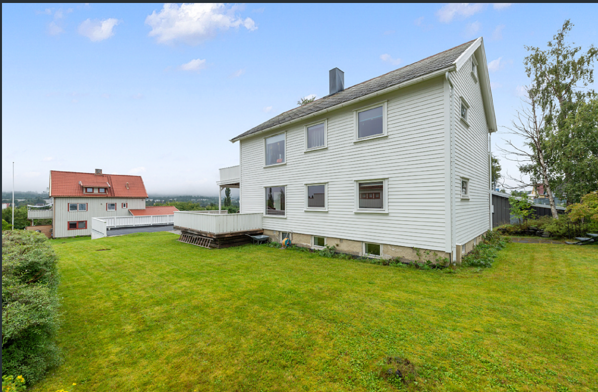
Taket er tekket med skiferstein som er i god stand. Pipehatter montert.
