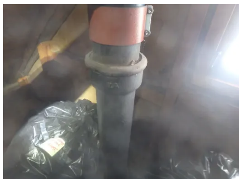
Soilrør på kaldtloft.
