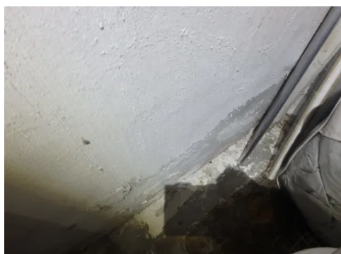
Salt/kalkutslag på innvendig mur.
