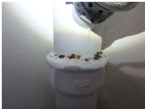
Rust på soilrør i kjeller.
