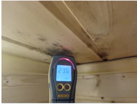
Høyt fuktinntrekk i paneloverflate.
