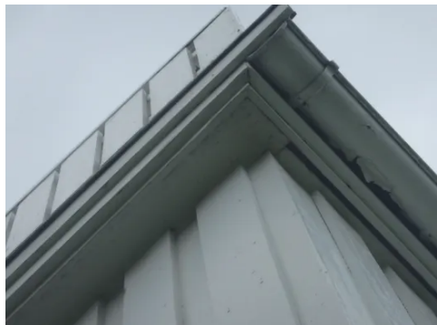
Tilløp til råte i kassebord i raft på takterrasse.
