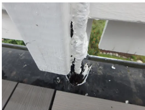
Rust i rekkverks innfesting.
