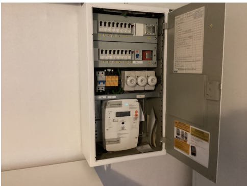
Bilde av sikringskap
