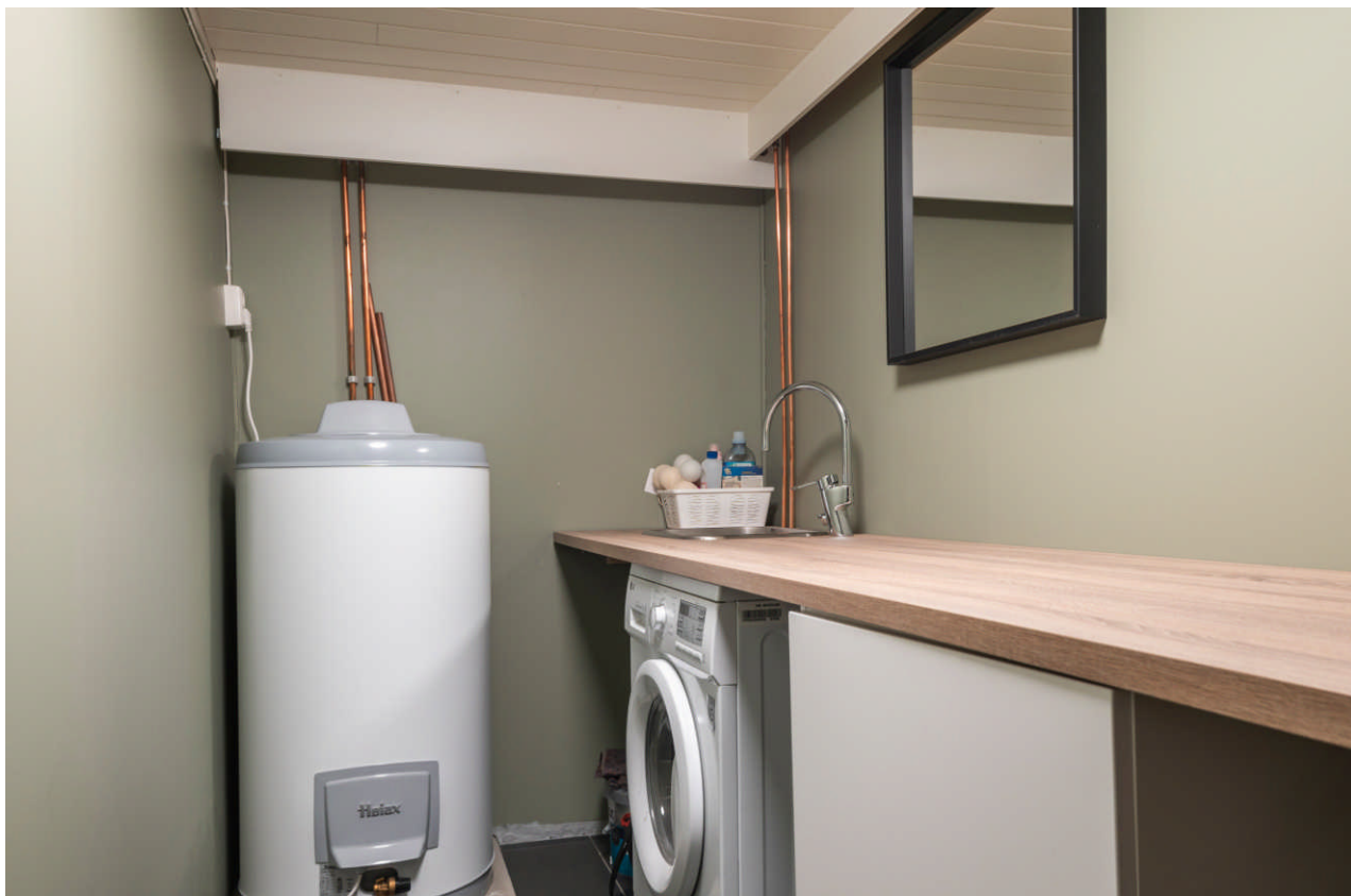
Nyoppusset vaskerom som tilhører leiligheten bakgården.
