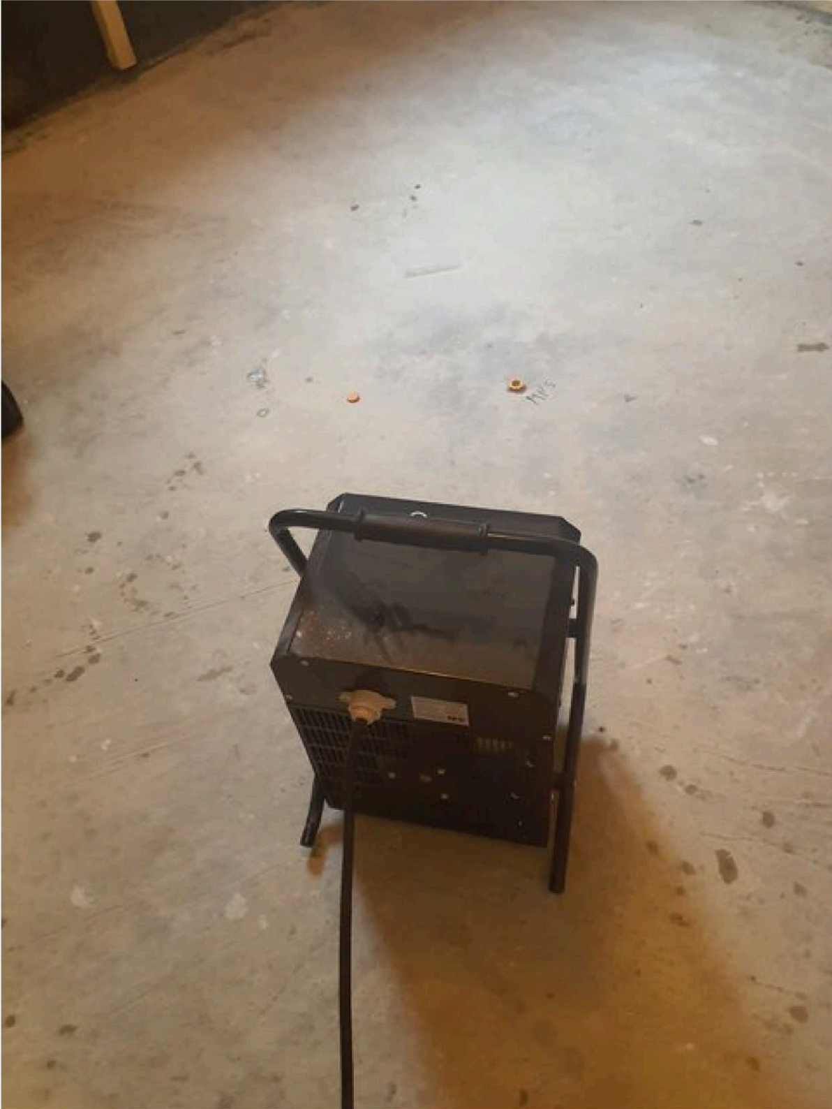
Varmerer installert i hoveddel og leilighet
