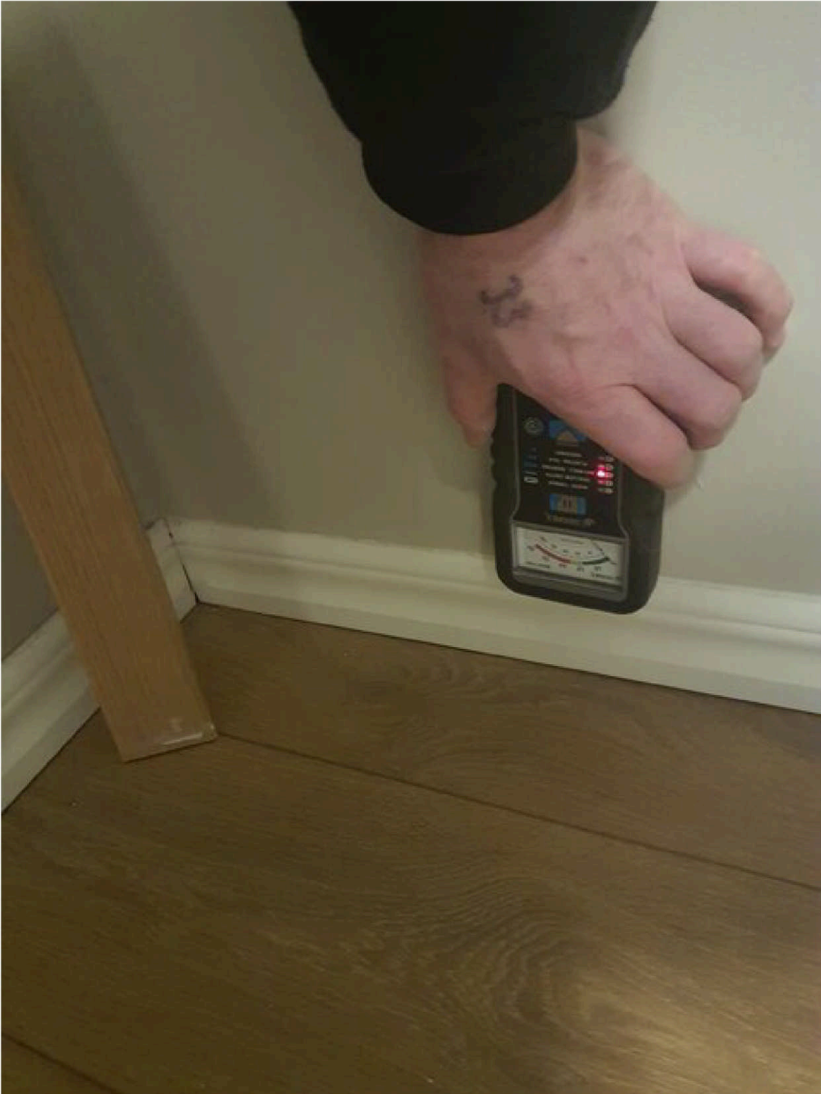
Hovedel gang tramex måling av vegg.
