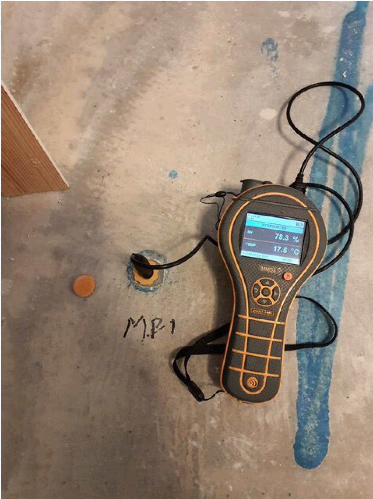
Mp1 Hovedel soverom gulv.
