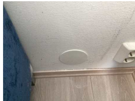
Hullet er plombert etter kontroll
