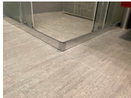
Ikke mulig for lekkasjevann utenfor dusjsonen å renne til sluket.
