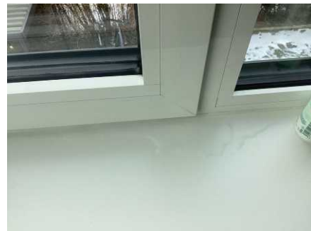
Oppsvullet foring på ene vinduet i 2 etg.
