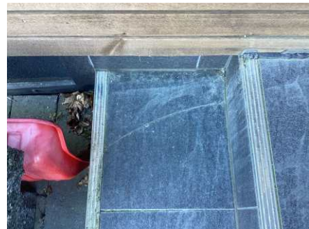
Sprekk i flis i trappen til utleiedelen.
