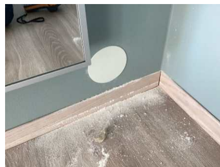
Hullet er plombert etter kontroll.
