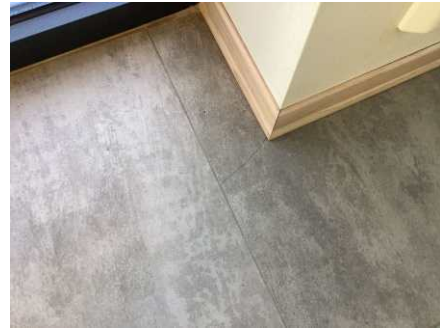
Liten sprekk i en flis i hallen.
