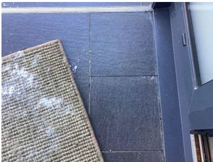
Avskaling i flis på trappen til hoveddelen.
