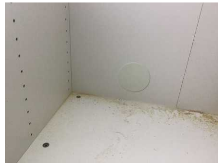
Hullet er plombert etter kontroll.
