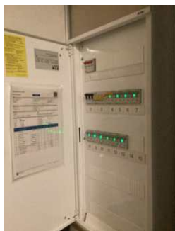
Sikringsskap med automatsikringer.
