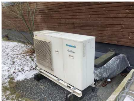
Varmepumpe fra Panasonic.
