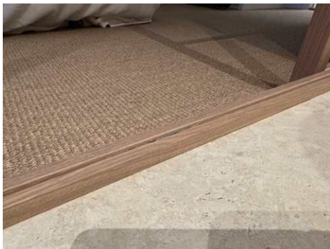
Overgang mot dørterskel.
