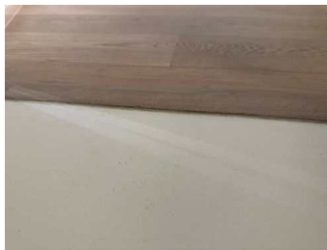
Overgang mot dørterskel.
