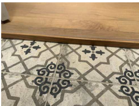
Overgang mot dørterskel.
