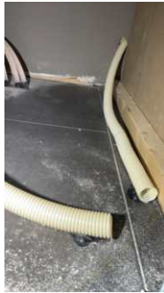
Avløp fra fordelerskap på vaskerom.
