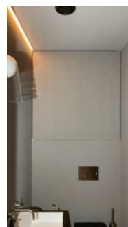
Luke over toalet? Fikk ikke åpnet ved befarig.
