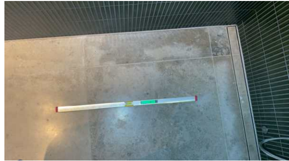
Fall mot sluk.
