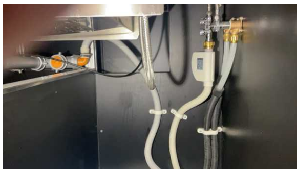
Ingen synlig lekkasjesikring.
