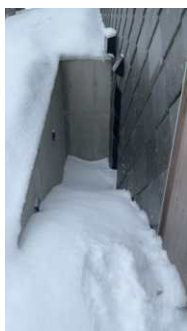
Manglende rekkverk på støttemurer.
