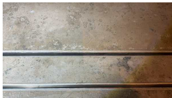
Lite riss i fuge mot sluk.
