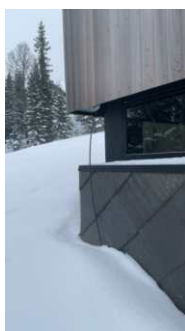
Utkast fra takrenne til terreng ved mur.
