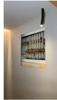
Fordelerskap toalettrom 1.etasje.
